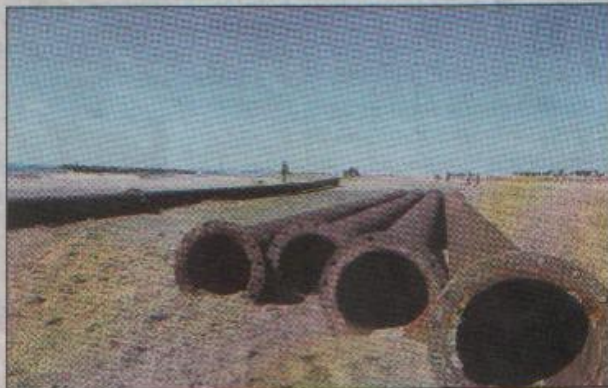
A Sète, un gros travail de réensablement a déjà été effectué. F. V.
